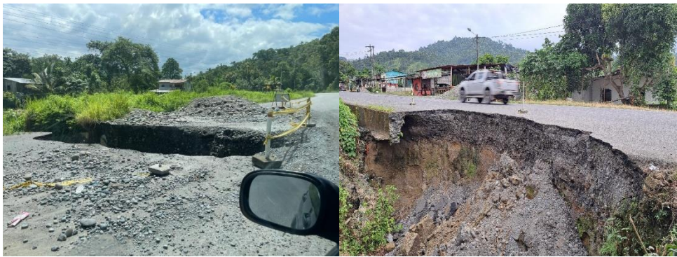
Ilustración 17. Daños en la vía Transversal Norte (E20)
